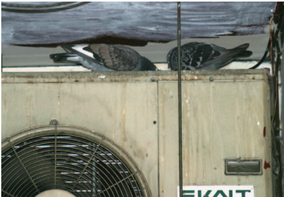
Abbildung 5: Mit Taubenkot verschmutzte Ventilationen und Klimaanlagen transportieren Krankheitserreger in das Innere von Gebäuden, wo es zu Infektionen beim Menschen kommen kann. Vor allem immunsupprimierte Patienten sind gefährdet.
