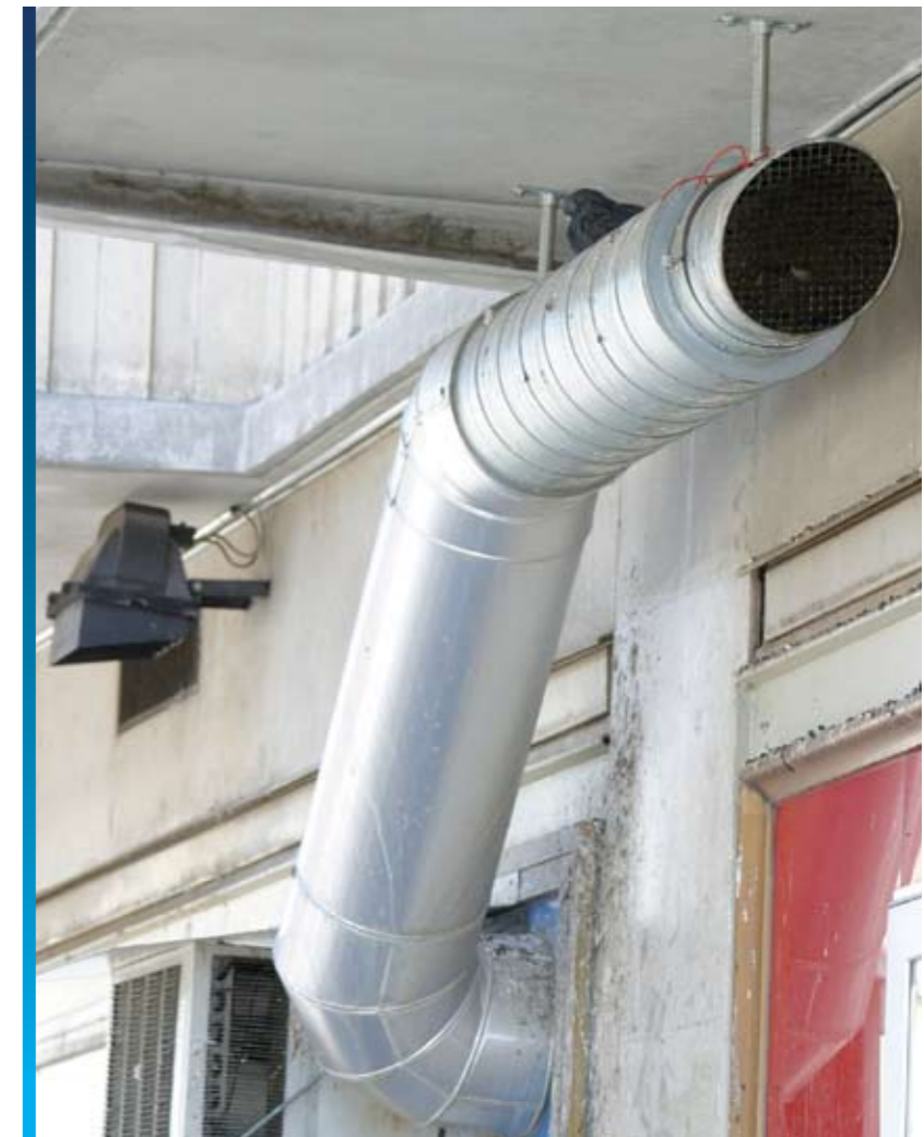
Verkotung von Ventilationen
